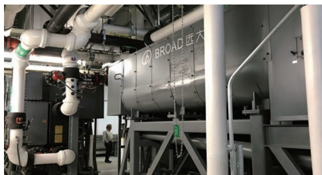
El Camino Hospital Mechanical Room 埃尔卡米诺医院机房
