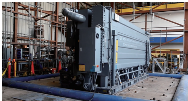
BROAD Chiller on the Shake Table in UC Berkley 远大空调在加州伯克利大学抗震测试台
